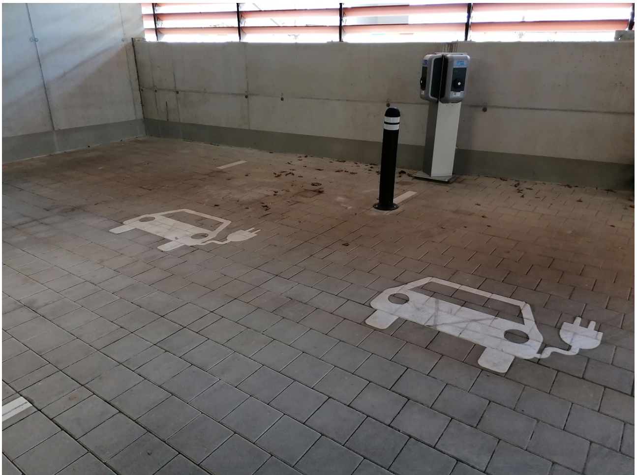
Foto: Neue Ladestationen im Parkdeck
